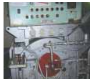
船内の焼却炉
