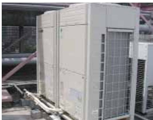
本社屋上に取り付けた空冷式室外機
