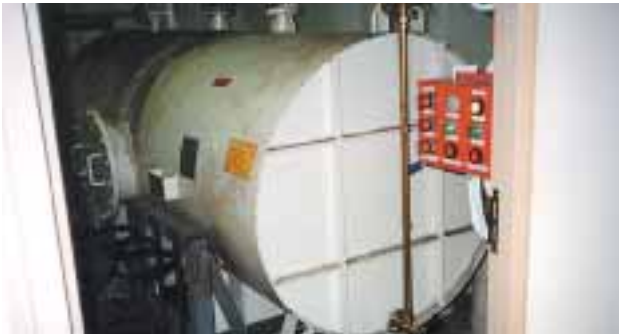
船内の高膨張式泡消火装置
