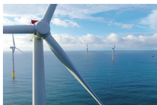
洋上風力発電所
