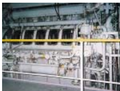
コージェネレーション・システム
